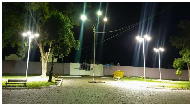
Figura 114 - Iluminação com LED
