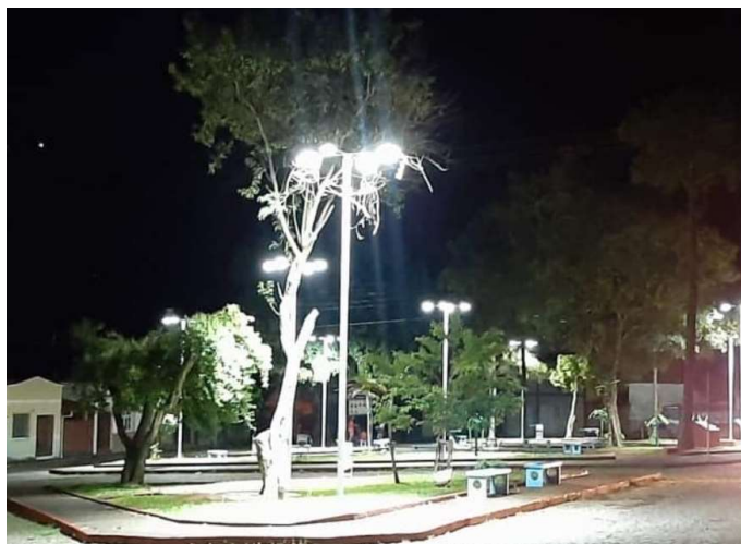
Figura 113 - Iluminação a Vapor de descarga em alta pressão
