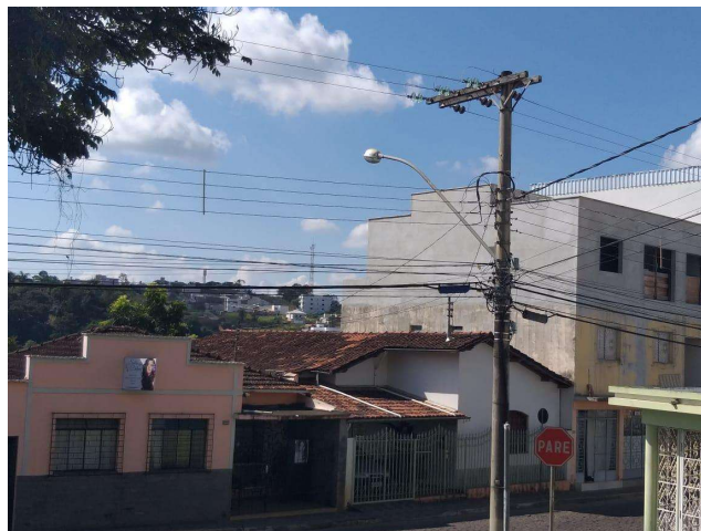
Figura 112 - Rede de fiação elétrica
