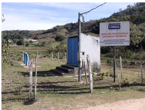
Figura 74 - Poço Artesiano localizado no bairro Boa Viagem
