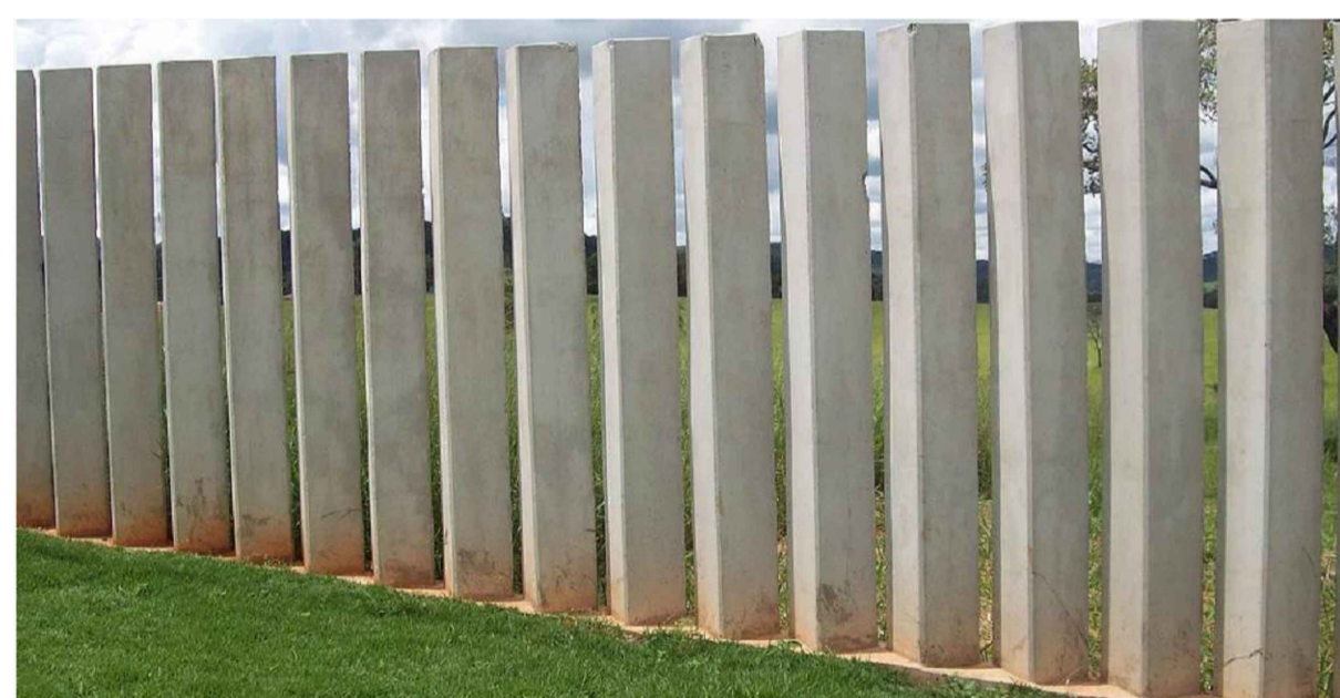
REF. DO MODELO DO MURO DE FECHAMENTO DO LADO DIREITO - M02 QUALQUER TROCA DEVERÁ SER APROVADA PELA FISCALIZAÇÃO
